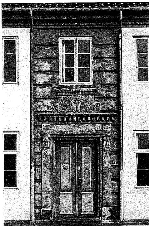
Facadeudsnit med det gråkalkede indgangsparti. Arbejdet udførtes under ugunstige vejrforhold sidst i november, blandt andet faldt temperaturen til under 4°C. Kalkningen holder dårligt.
