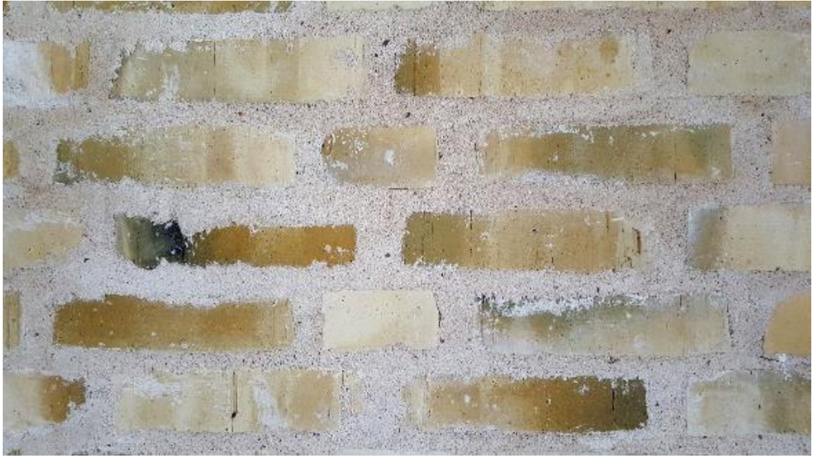
2. 10 Kirkerummets murværk med grov fuge og fingeraftryk
